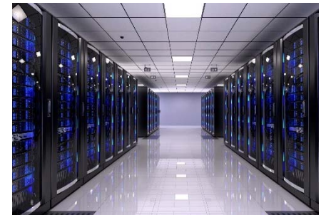
サーバールーム温度監視
