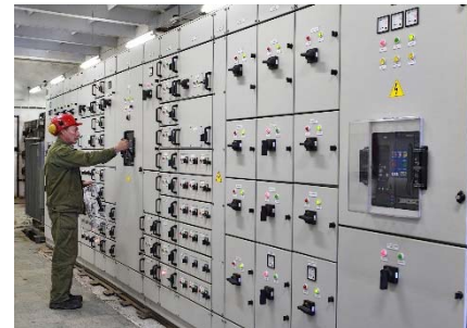
受変電設備異常検知
